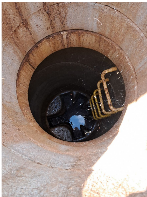
Point de prélèvement des eaux industrielles
