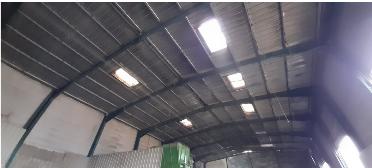
Figure 4: Levée de non conformité avec mise en place de trappes de désenfumage supplémentaires
