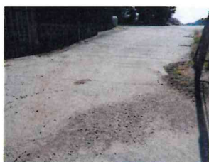
eaux pluviales passage bétonné pour les animaux
