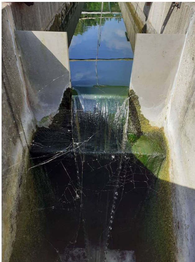
(2) Présence de mousses/algues sur les parois du déversoir
