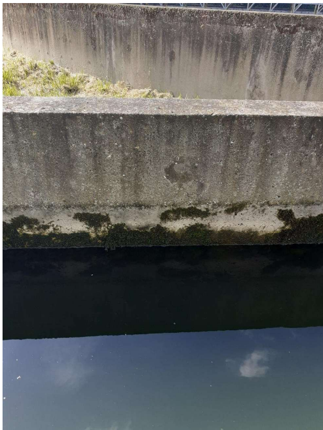
(1) Présence de mousses sur les parois du canal
