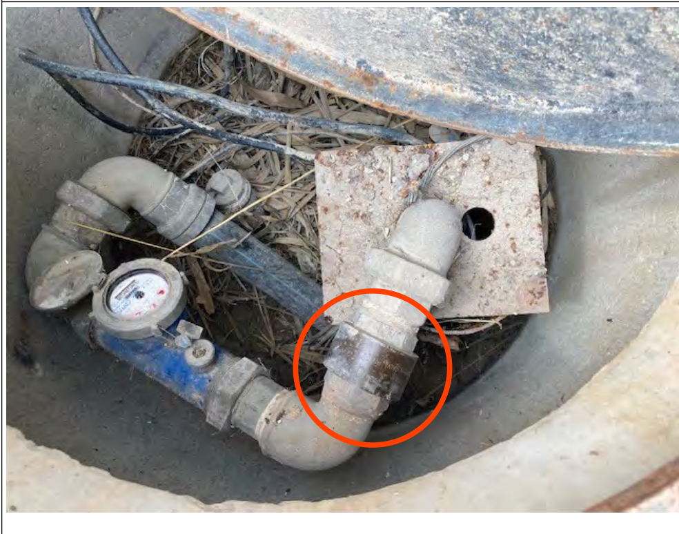
Photo n°4 – présence d'un disconnecteur
