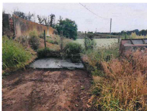
Décanteur et grilles à l'entrée du bassin de stockage des eaux pluviales
