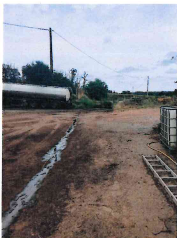
Ecoulement des eaux de lavage des poids lourds vers le bassin de stockage des eaux pluviales.
