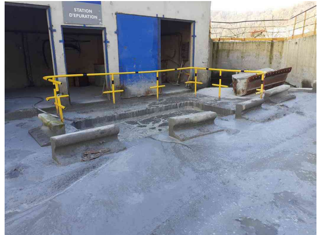
Illustration 2 : nouveau bac de décantation des eaux pluviales de l'UTM avant rejet dans le bassin de décantation
