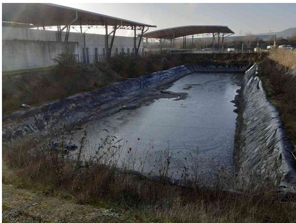
Illustration 3 : bassin de décantation des eaux pluviales de l'UTM
