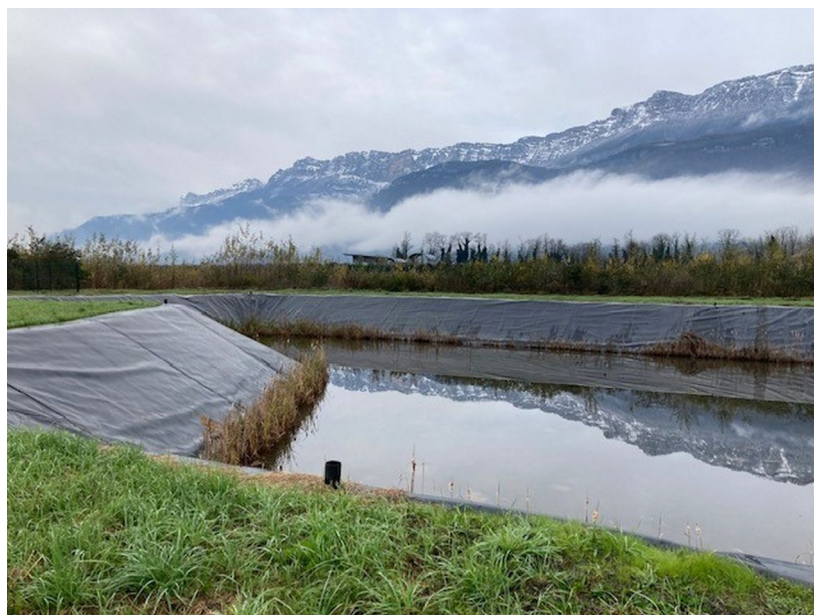
Bassin de rétention : présence de végétation et d'une couche de dépôt en fond de bassin
