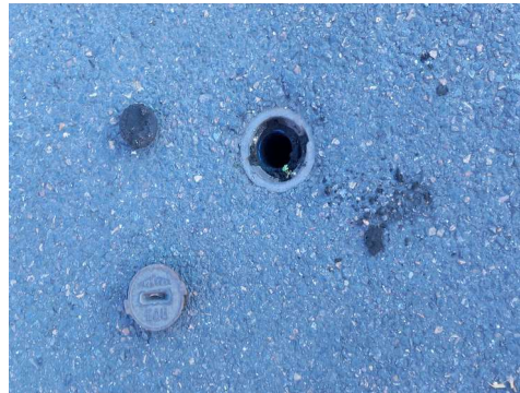
L'ouvrage PZ2 n'est pas clairement identifié.
