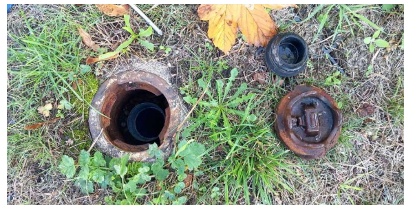
Présence de végétaux autour de PZ5. La margelle n'est plus visible.
