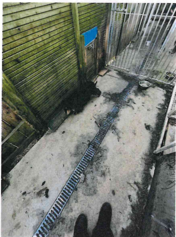
Canalisation bouchée du chenil
