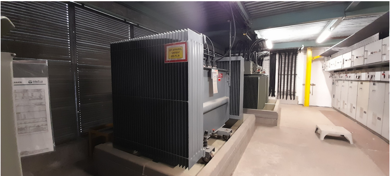
Figure 3: Le transformateur restant se situe dans un local dédié fermé. Il est placé sur rétention et ne présente pas de traces d'écoulements
