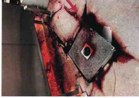
Revêtement de sol fortement dégradé
