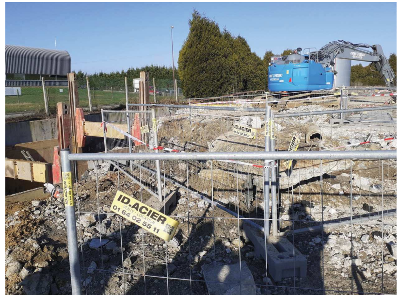
Matériaux potentiellement amiantés stockés dans une zone délimitée par barrières et rubalise
