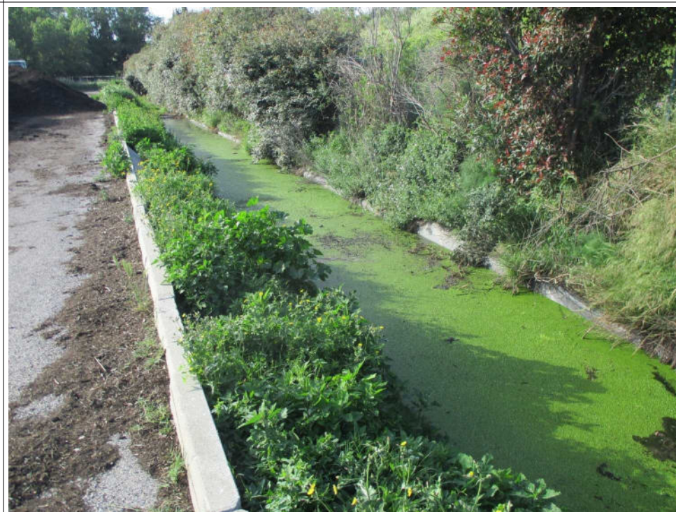
Bassin étanche dans lequel les eaux d'incendie ont été confinées
