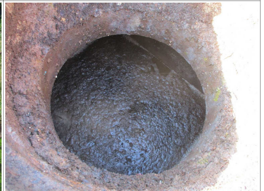
Niveau des boues dans le déboureur/séparateur d'hydrocarbures
