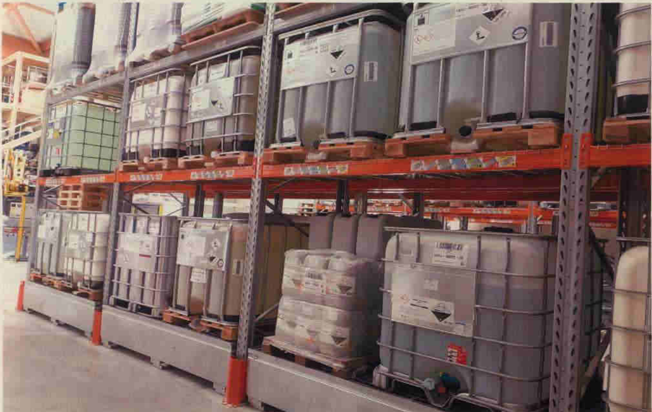
Produits dangereux stockés sur rétention, volume de rétention non adapté à la quantité stockée.
