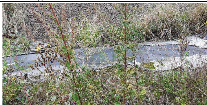
L'étanchéité est-elle toujours assurée ?
