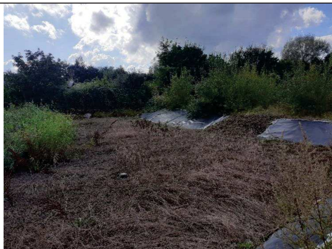
Bassin de confinement des eaux incendie
