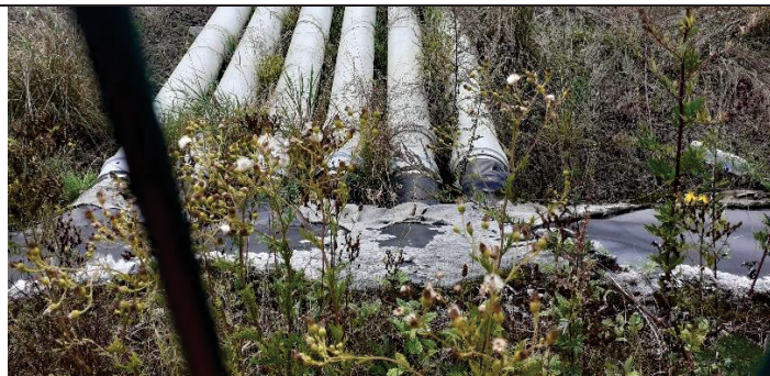
La membrane du bassin présente des détériorations
