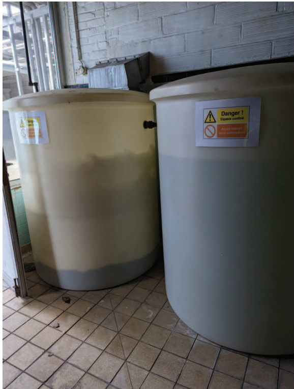
Cuves de sel et d'eau présentes dans le bâtiment de production
