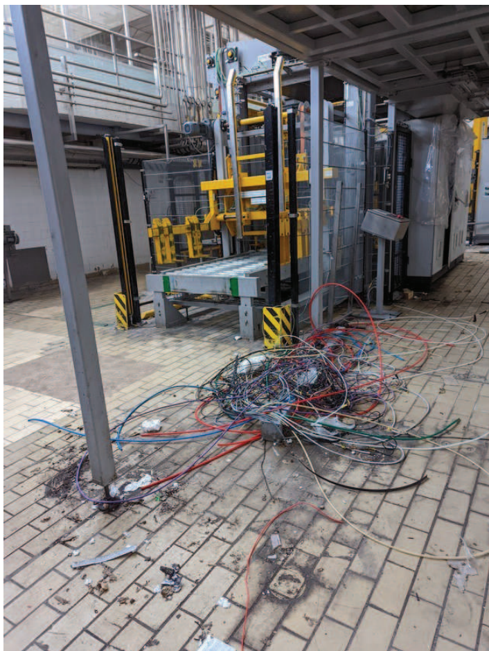
Déchets électriques et ligne de production encore sur site
