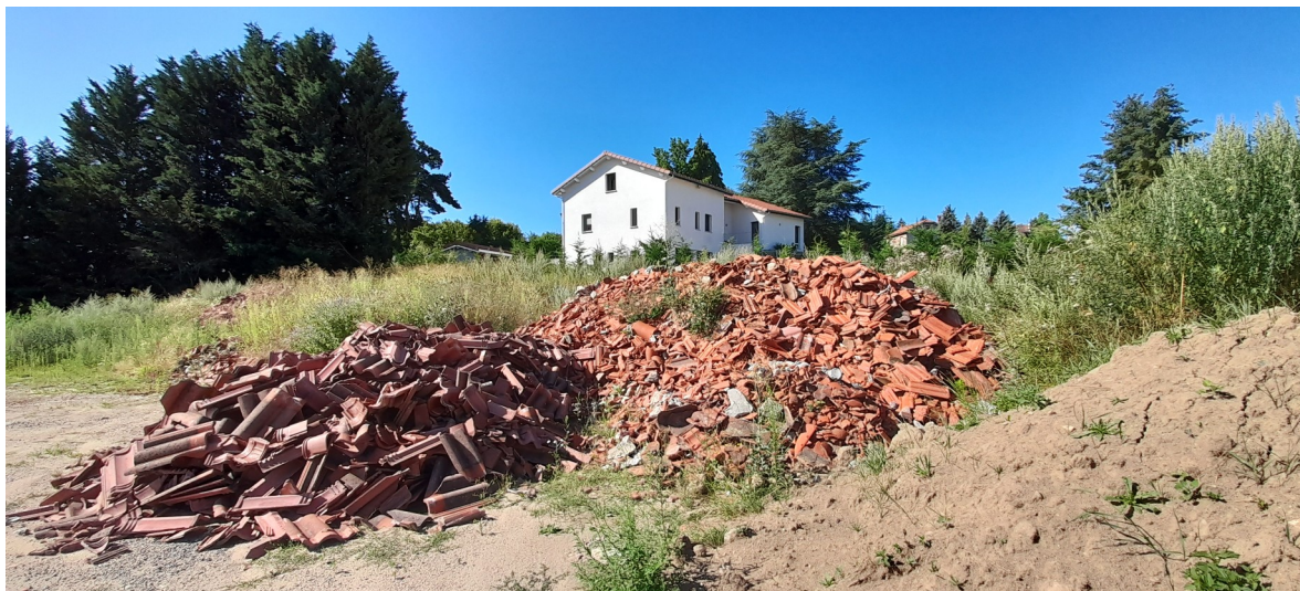
Figure 4: Présence de déchets de démolition (tuiles)
