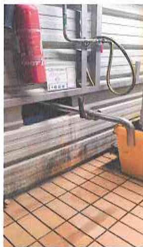
Robinetterie le jour de l'inspection
