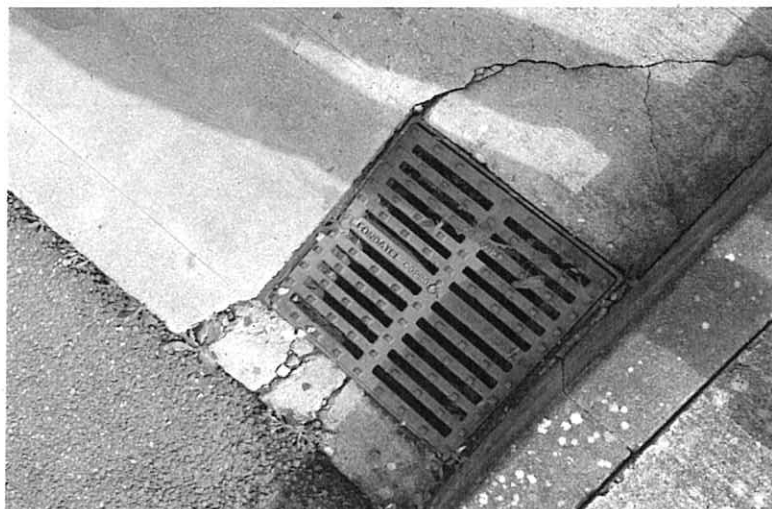
Figure 1: Avaloir en sortie de la zone de distribution
