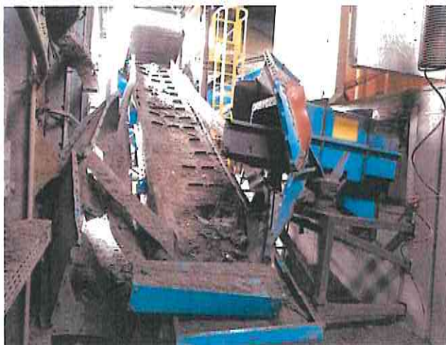
Photo 2 : conduite du sortie des fractions de PAM produites par le QZ. Noter les tôles arrachées et tordues sous l'effet du souffle de la surpression produite par l'explosion
