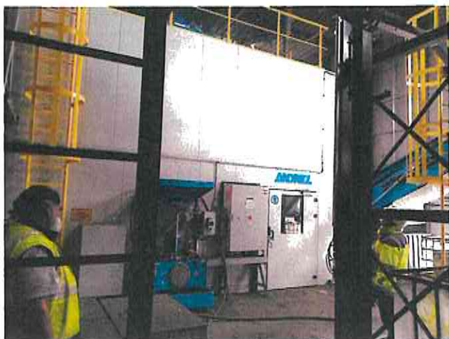
Photo 7 : vue du caisson abritant le QZ, à l'intérieur du bâtiment
