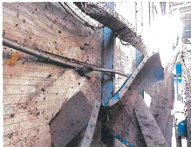
Photo 6 : canalisation et gaine présentes sur le bardage interne du bâtiment, face à la sortie du PZ, déformées par le souffle
