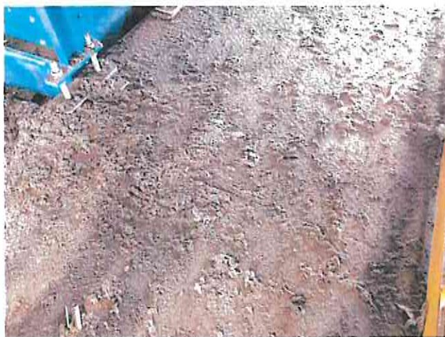
Photo 9 : dépôt de poussière sur la dessus du caisson abritant le QZ
