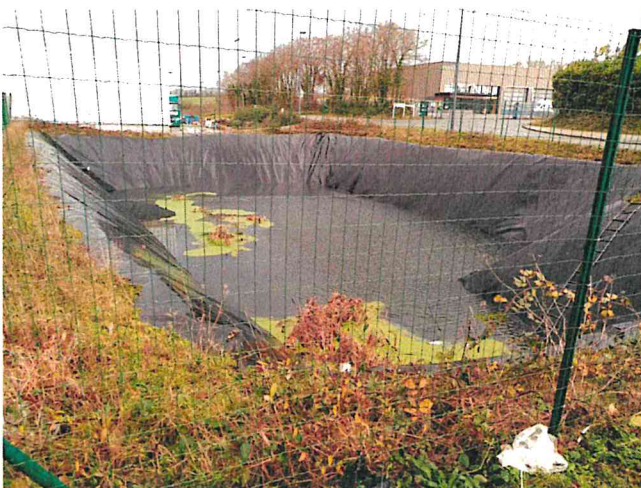
Photo 13 : bassin étanche de confinement et regulation du debit de rejet au milieu
