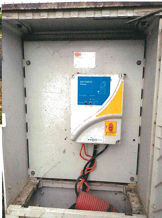
Photo 14 : commande de la pompe de vidange du bassin
