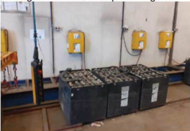
Stockage de batteries, zone de danger non identifiée
