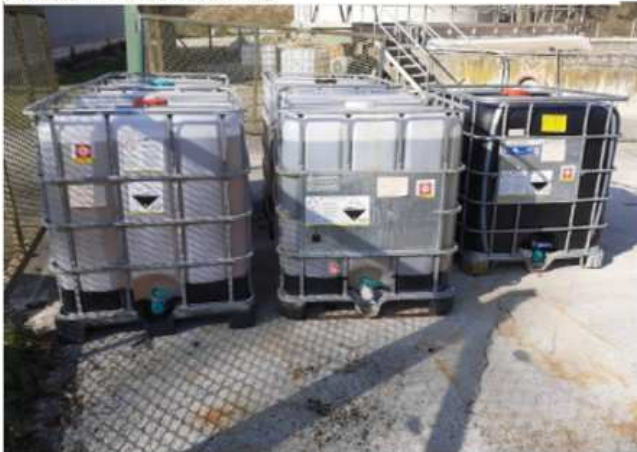
Stockage de produits chimiques sans rétentions à proximité immédiate de la limite de propriété, zone non imperméabilisée
