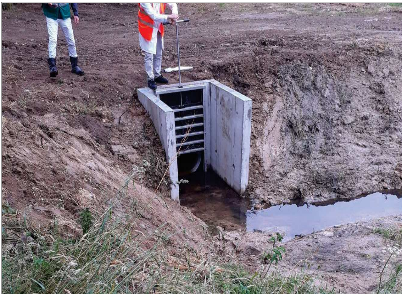
Test de fermeture de la vanne d'isolement
