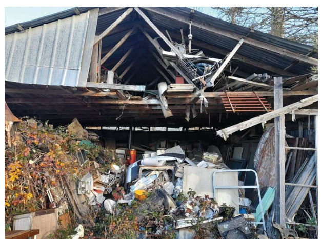
Photo n°12 – Grange remplie de déchets et dont la structure semble fragile
