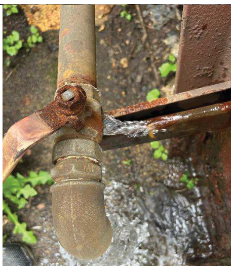
Vanne de vidange fendue – A remplacer
