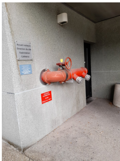
Colonne d'aspiration accessible et signalée
