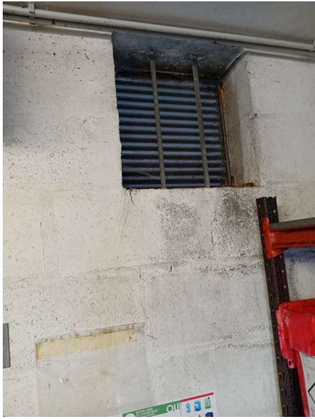
Grille de désenfumage en place dans le local DDS
