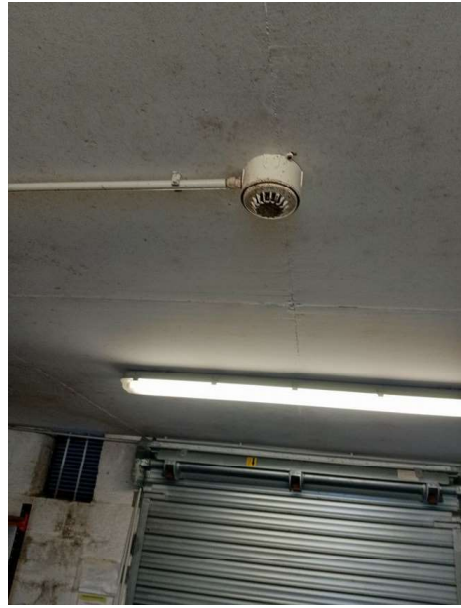
Déflecteur de fumée visiblement non entretenu
