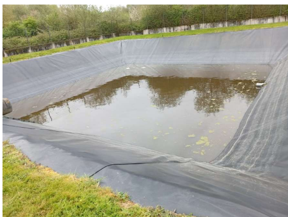
Bassin de traitement des eaux pluviales et de confinement des eaux d'extinction
