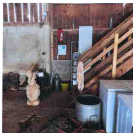
Emplacement de l'extincteur
