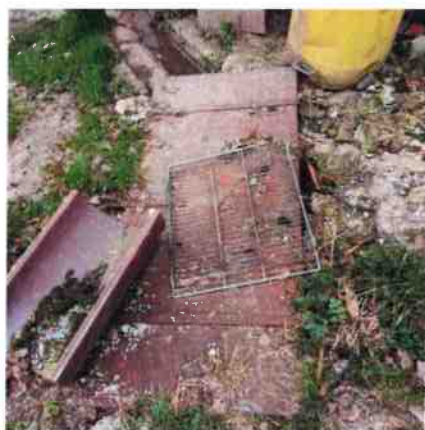
Plaques accès fosse
