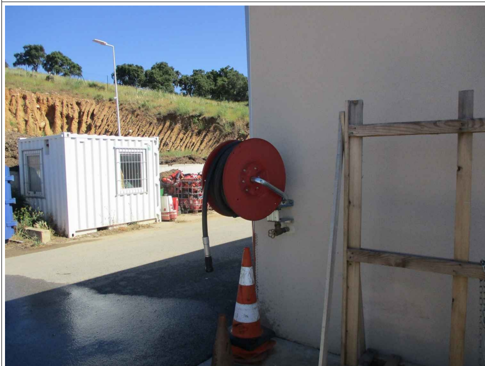
RIA fixé sur la façade Ouest du bâtiment abritant les déchets d'équipements électriques et électroniques
