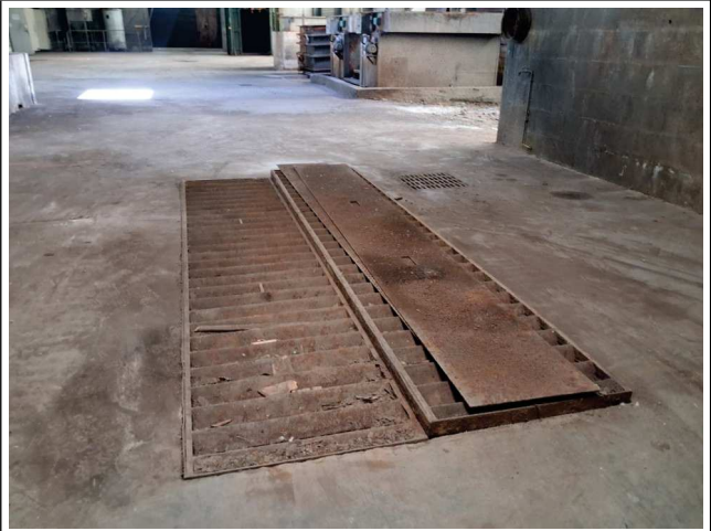
Fosse de rétention enterrée
