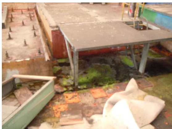
Présence de liquide à proximité de la fosse contenant des déchets divers
