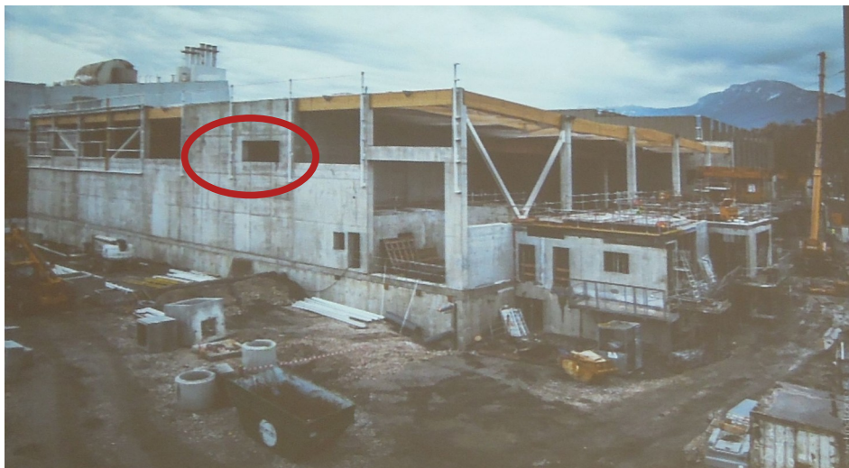
Photo à la construction du centre de tri : présence d'une ouverture au niveau de la façade nord-est coupe feu 2h du hall amont non prise en compte dans l'étude des flux thermiques.
