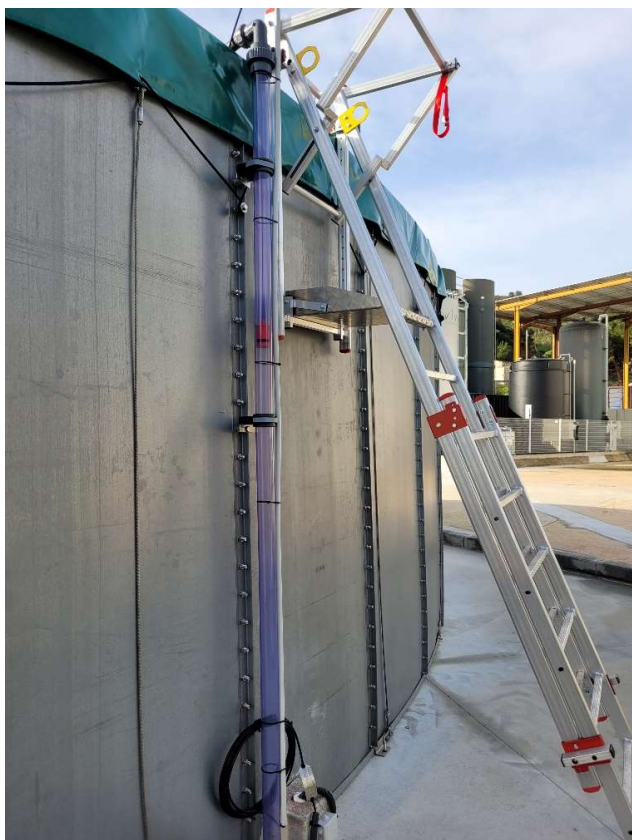
Repère de niveau positionné en paroi externe du bassin de 650m 3 et échelle amovible d'accès
