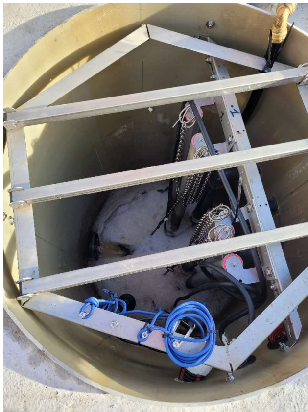
Arrivée des lixiviats (talus Sud et Est) au niveau du poste de refoulement
