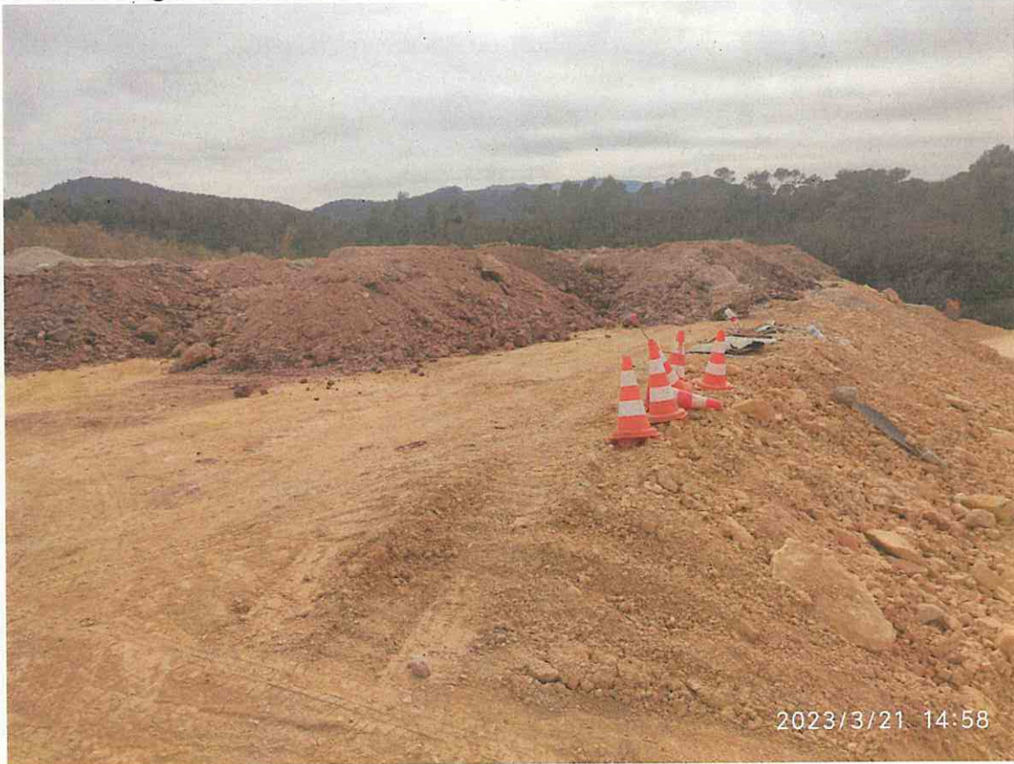
Vue sur les stockages de terre de terrassement apportées sur les parcelles 140 F 499 et 140 F 500.
