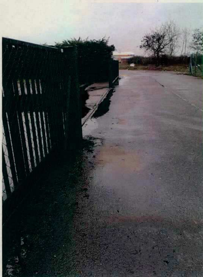
Vue sur la voirie et parking de la société voisine irisations constatées
