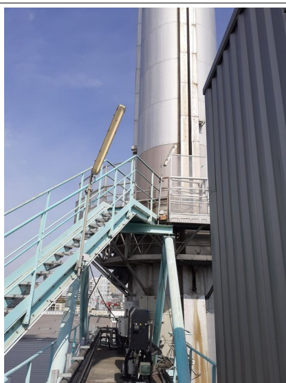
Plate-forme de mesure
