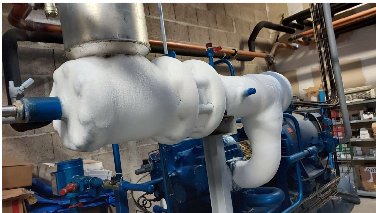
Figure 1: Equipement "Centrale Hall" - Présence de glace
