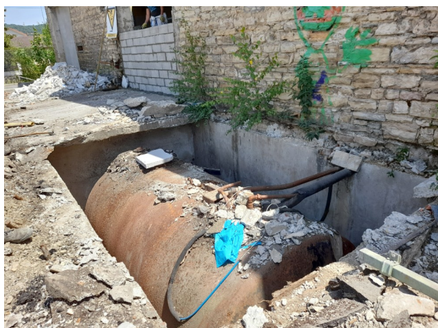
Photo 1 : Cuve de FOD accolé au bâtiment C1
