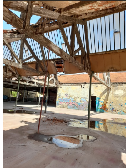
Photo 4 : Chute de tuiles de la toiture du bâtiment C1
