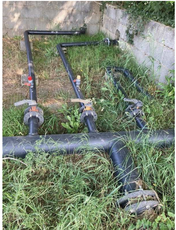
Raccordement des 3 lignes de récupération du biogaz
