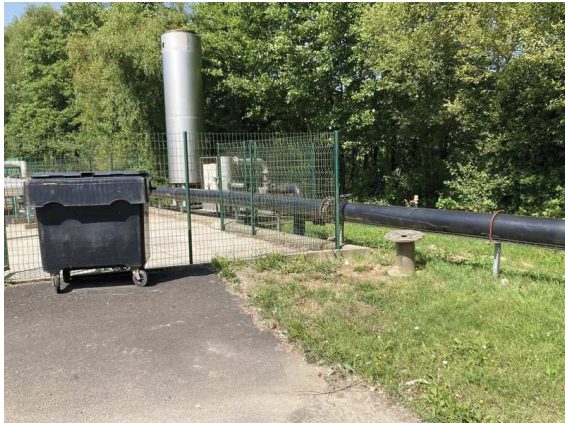
Canalisation avant valorisation du biogaz
