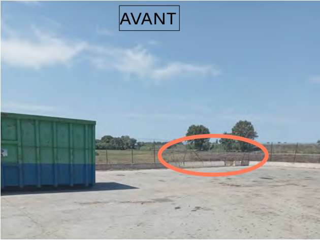
Muret n°2 à réparer à l'Ouest du site (visite du 27/08/2024)
