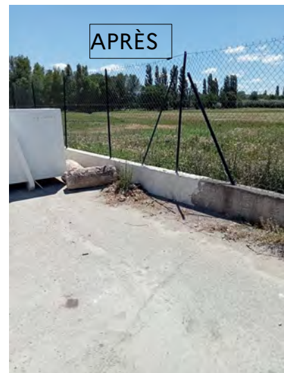
Muret n°1 à réparer à l'Ouest du site (visite du 26/05/2025)
