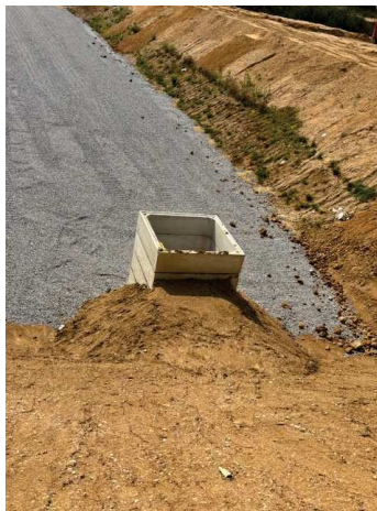
Point de pompage du casier 2
