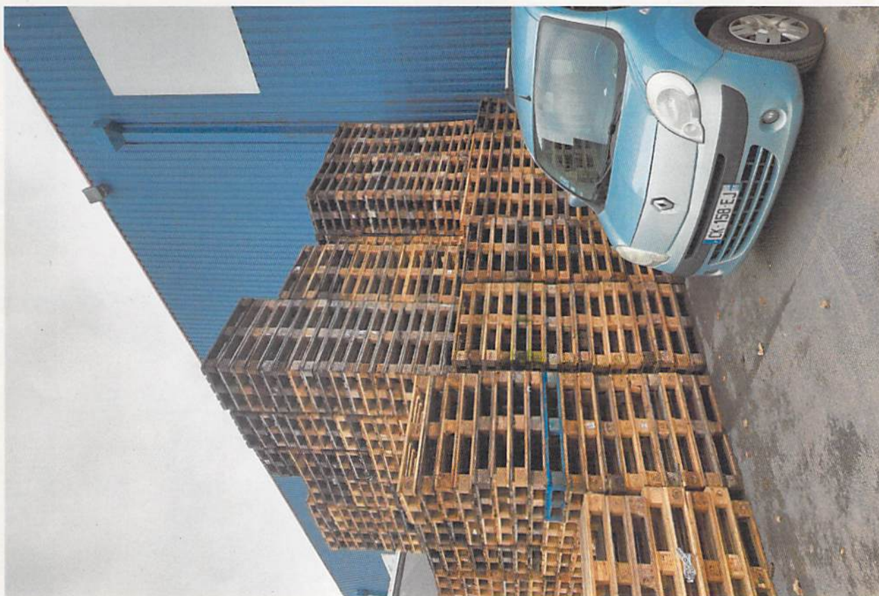
Stockage extérieur de palettes de bois non séparé du bâtiment de stockage par un mur REI 120
