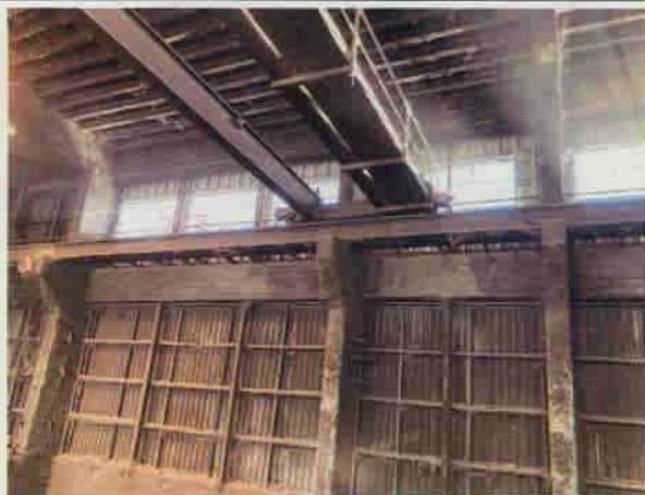
Désenfumage naturel en partie haute de la fosse d'ordures ménagères (OM)
