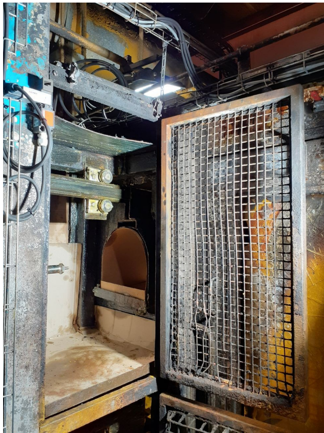
Lieu du départ de feu (cabine de peinture)
