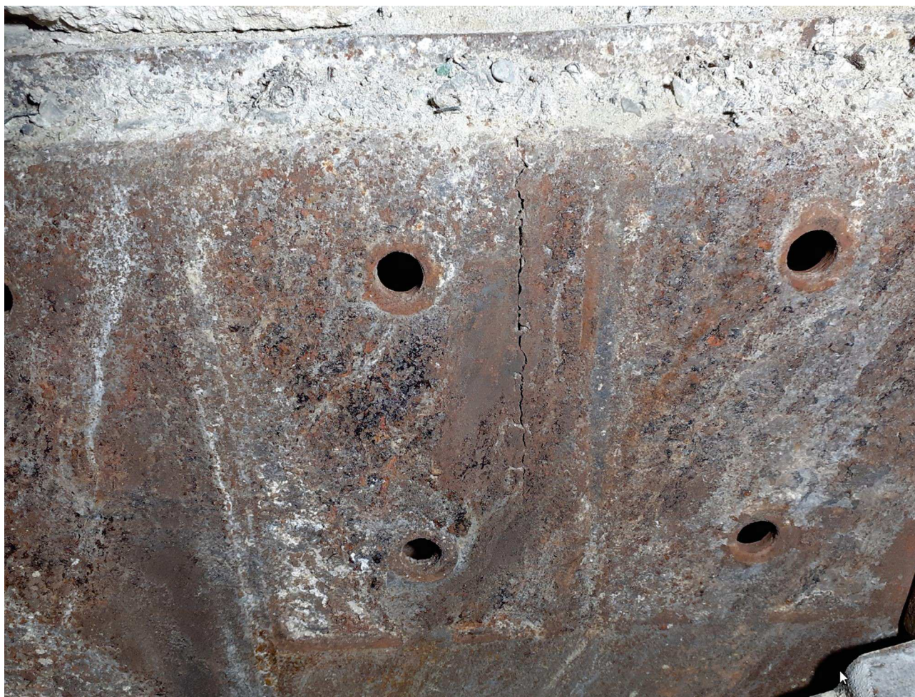
fissure traversante du châssis du four
