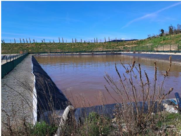
Bassin de récupération des lixiviats LCJ3
