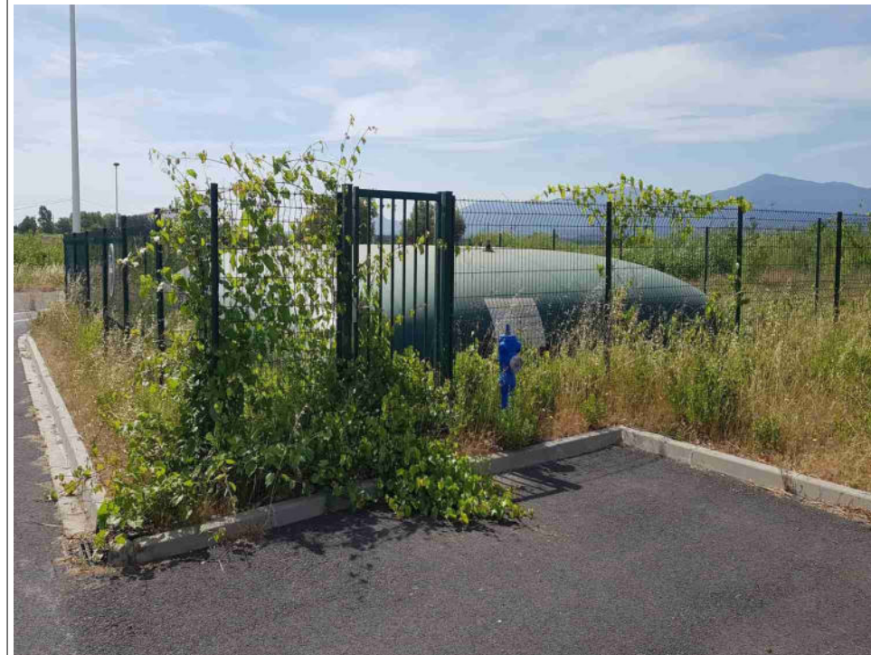
Citerne souple contenant la réserve d'eau incendie reliée à un poteau incendie dédié (poteau bleu sur la photographie)
