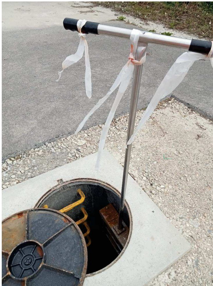
Dispositif d'obturation des effluents
