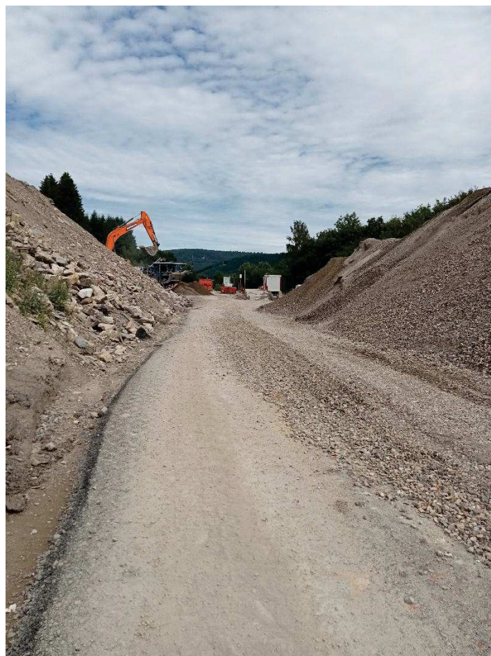
Surface imperméabilisée mais sans collecte des effluents
