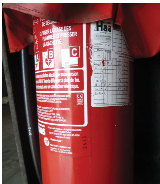
Extincteur cité au constat n°4
